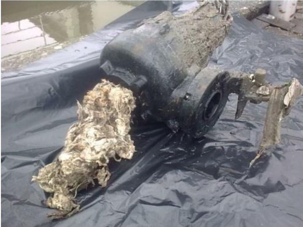
Verstopfung durch Zellstoffe RÜB Ziegelhütte 2017
